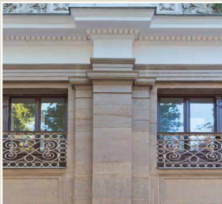
Praterstraße 42 im Detail: Setzungen und Risse in der historistischen Fassade wurden sorgfältig gesichert und hinterfüllt. (Foto: Richard Watzke)
